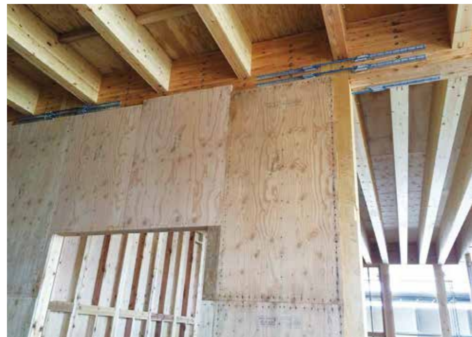
厚さ24mm構造用合板による耐力壁の施工現場 (CN75@50mm 両面張り 許容耐力47.6kN/m)
